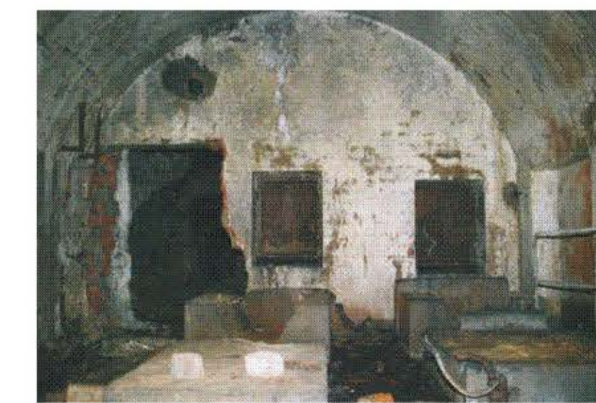
Maschinenraum mit Sockel der beiden Maschinensätze
